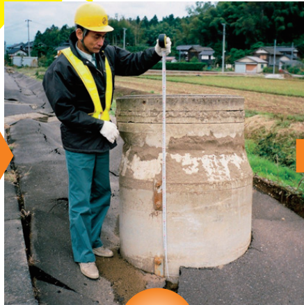
マンホール浮上
